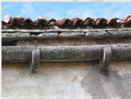
Na sliki: Kamnit žleb na hiši, v Matavunu št. 8
